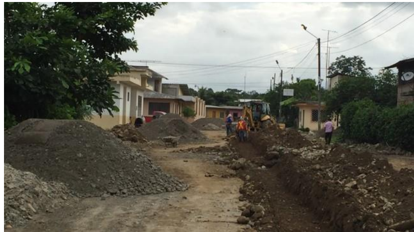
FOTOGRAFÍA 2.5.51 CANTÓN CAMILO PONCE ENRÍQUEZ: Proyecto del sistema de alcantarillado en la comunidad de Shumiral, 2015
