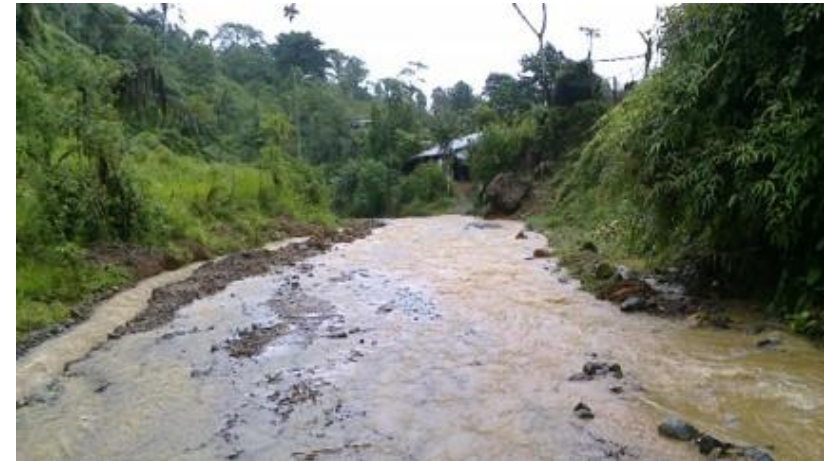
FOTOGRAFÍA 2.5.12 CANTÓN CAMILO PONCE ENRÍQUEZ: Falta de cunetas, vía a la comunidad de Pijilí
