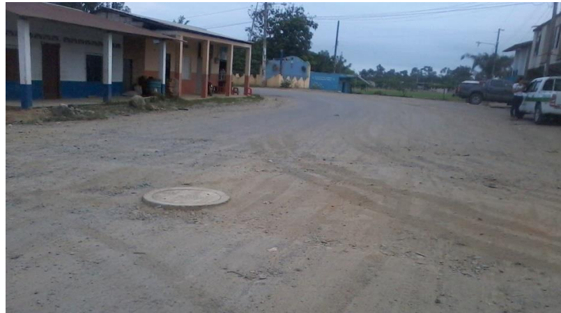
FOTOGRAFÍA 2.5.25 CANTÓN CAMILO PONCE ENRÍQUEZ: Calle asfaltada de Shumiral en mal estado
