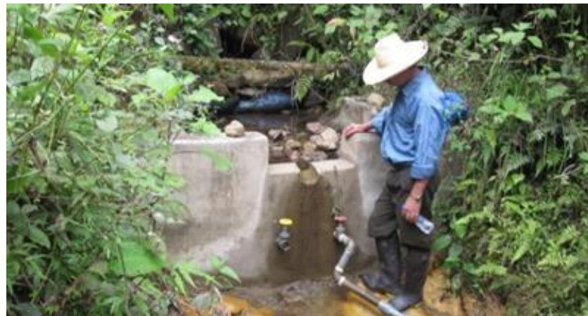
FOTOGRAFÍA 2.1.45 CANTÓN CAMILO PONCE ENRIQUEZ: Toma de agua de tipo Azud convencional. Sector La Rica.
