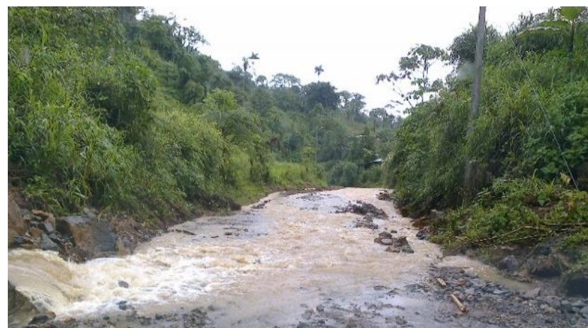
FOTOGRAFÍA 2.5.11 CANTÓN CAMILO PONCE ENRÍQUEZ: Falta de alcantarilla, vía a la comunidad de Pijilí
