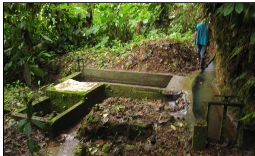
FOTOGRAFÍA 2.1.4 CANTÓN CAMILO PONCE ENRIQUEZ: Sistema de captación de agua potable (Shagal).
