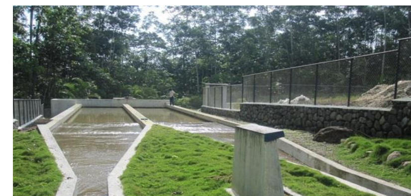
FOTOGRAFÍA 2.5.55 CANTÓN CAMILO PONCE ENRÍQUEZ: Planta de agua potable de la cabecera cantonal
