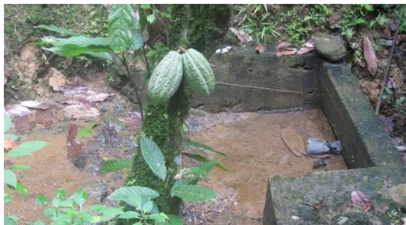
FOTOGRAFÍA 2.5.53 CANTÓN CAMILO PONCE ENRÍQUEZ: Captación tipo azud convencional, sector la independencia
